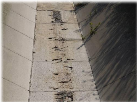
Degrado attuale del fondo del CSNO.
